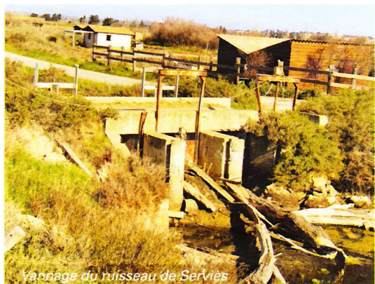
Vannage du ruisseau de Servies
